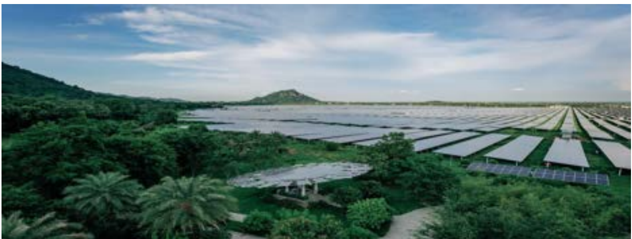
Điện mặt trời An Hào
